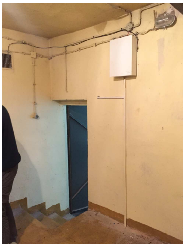
Maszynownia widoczna wentylacja grawitacyjna pomieszczenia
